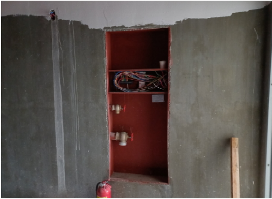
[ 각 층 소화전 설비 ]
