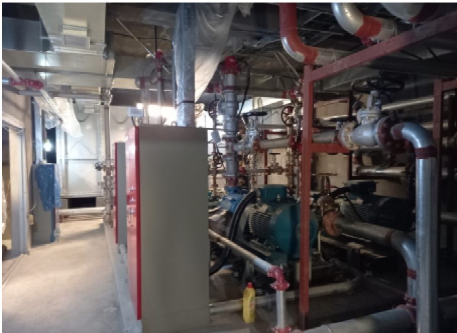
[ 지하층 기계실 및 펌프 ]
